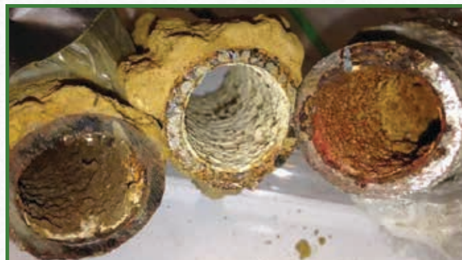
FIGURE A.25 : ÉCHANTILLONS DE TUYAUX EN FONTE CORRODÉS EN PROVENANCE DE FLINT, AU MICHIGAN
